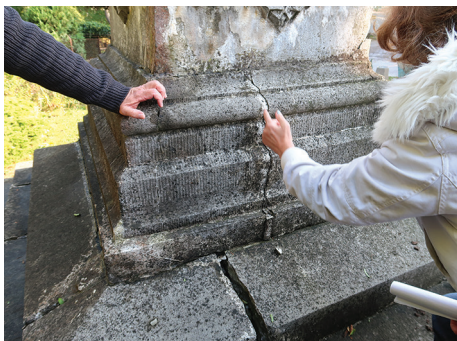
Cokół przed wykonaniem prac w 2020 r. – widoczne liczne uszkodzenia i spękania.
