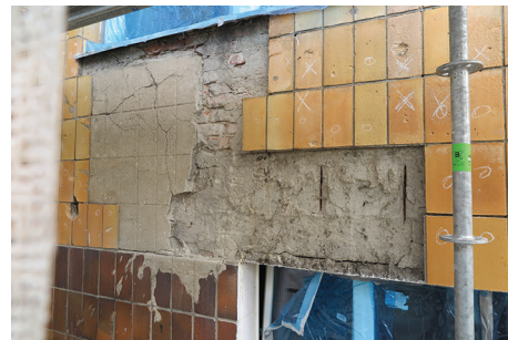
Zniszczone partie elewacji.
