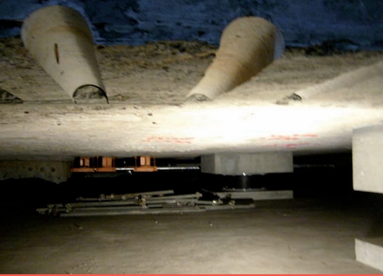
8. Wzmocnienia sejsmiczne zastosowane w Narodowym Muzeum Sztuki Zachodniej, Uenokoen, Tokio, Japonia, 2008 (fot. A. Tostões)
