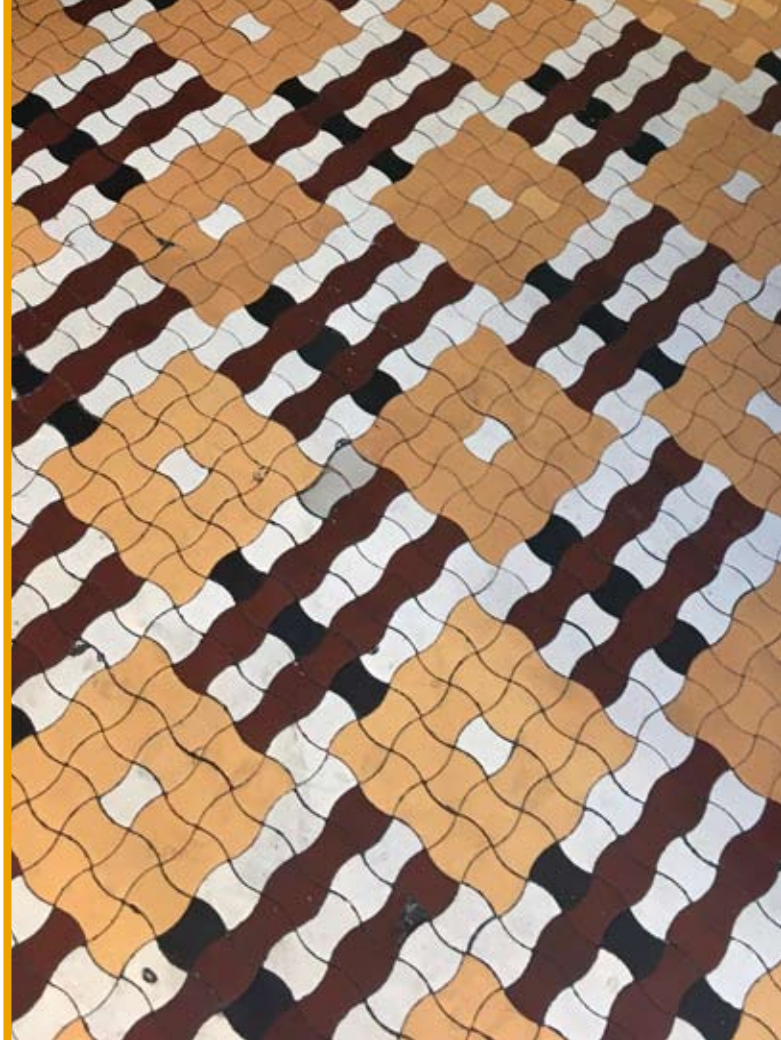
12. Fragment kompozycji posadzki w lokalu handlowym przy ul. Legionów 56, 2020 r. (fot. W. Szerle)
