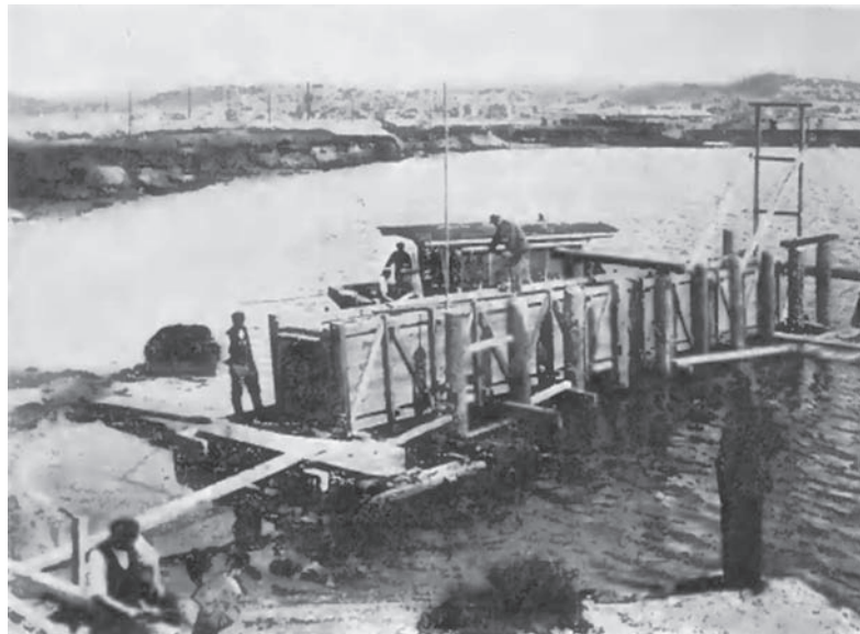
5. Gdynia, elektrownia „Gródek” w porcie, zdjęcie czerpni wody chłodzącej w trakcie budowy, arch. Czesław Kłós, rok budowy 1935-36 (źródło: K. Pomianowski, Roboty wodne przy budowie elektrowni parowej „Gródka” w Gdyni - Porcie, „Przegląd Elektrotechniczny” 1936 nr 23, s. 798)
